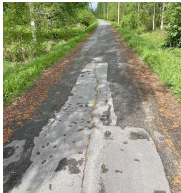
Alavuden Santerinlammen kevyt väylä aseman suuntaan on ollut huonokuntoinen jo pitkään. Nyt sitä päällystetään tänä kesänä 400 metrin matkalta.
